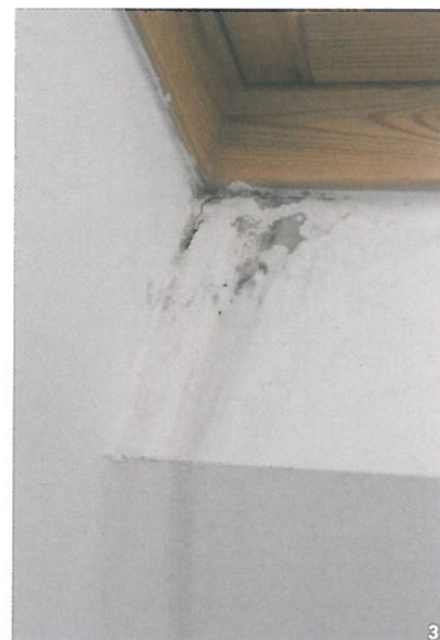
3 Schimmel ist eine der häufigsten Folgen von Kondensat am Fenster.
