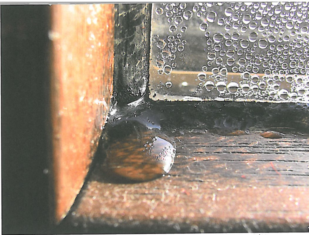
1 Kondenswasser im Fensterbereich wurde in letzter Zeit verstärkt zum Problem.
